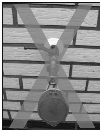
Nicht zulässige Installation eines Zwischenzählers
