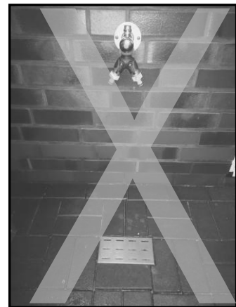
Nicht zulässiger Bodenablauf
