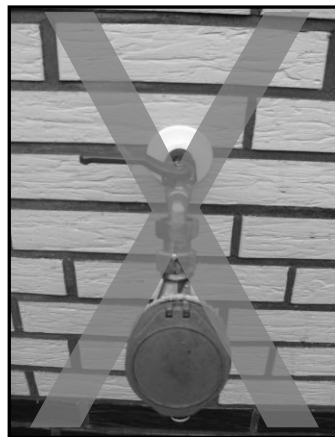
Nicht zulässige Installation eines Zwischenzählers
